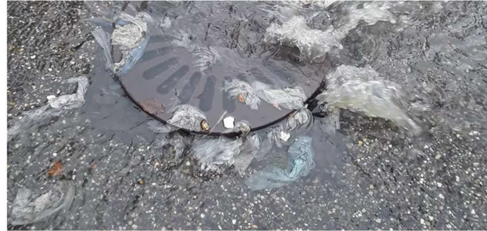
▲ Maarsbergen, via een put in de parallelweg van de Woudenbergseweg komt water uit het riool naar boven. © Privéfoto
