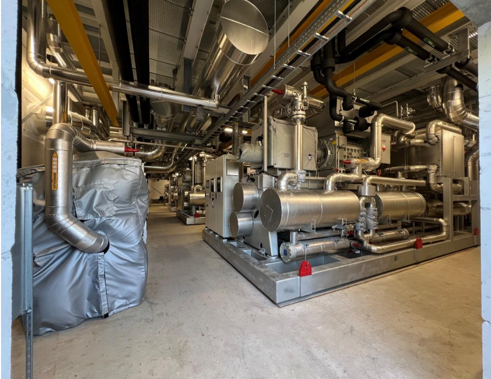
Grootste warmtepomp van NL – 27MWth
