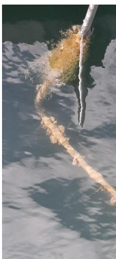
Figuur 5 Illustratie van aangroei op een zonnepark. Foto van de Groenleven zonnepark in Uivermeertjes circa twee jaar na installatie. Foto door M. Dionisio-Pires.
