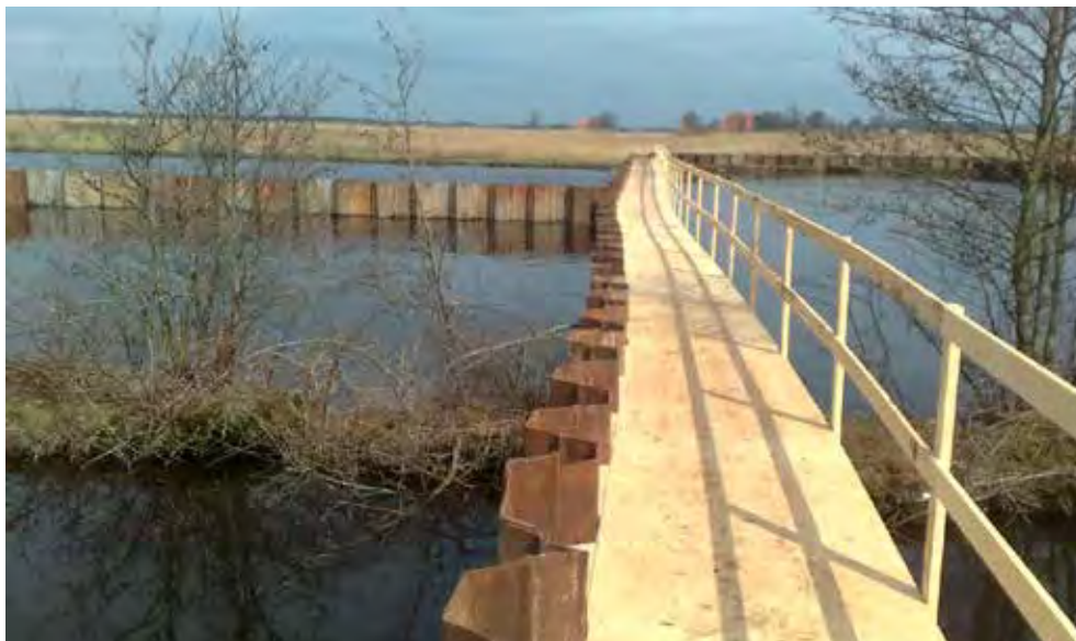
FIGUUR 4.8 ER WERD EEN LOOPSTEIGER AAN HET COMPARTIMENT IN DE ROTTIGE MEENTE BEVESTIGD, ZODAT DEZE TOEGANKELIJK WERD VOOR INSPECTIE EN BEMONSTERING
