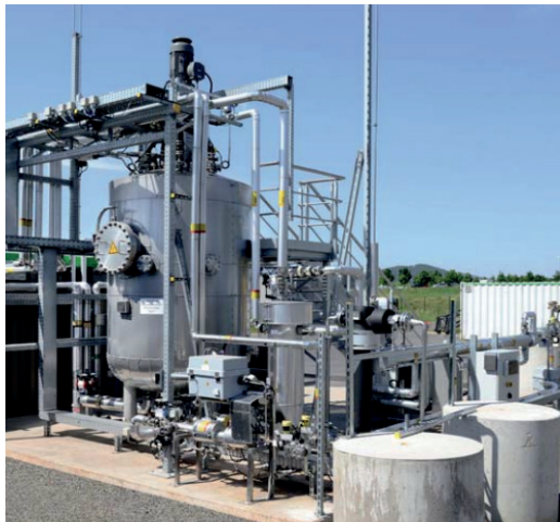
P2G INSTALLATIE MICROENERGY
