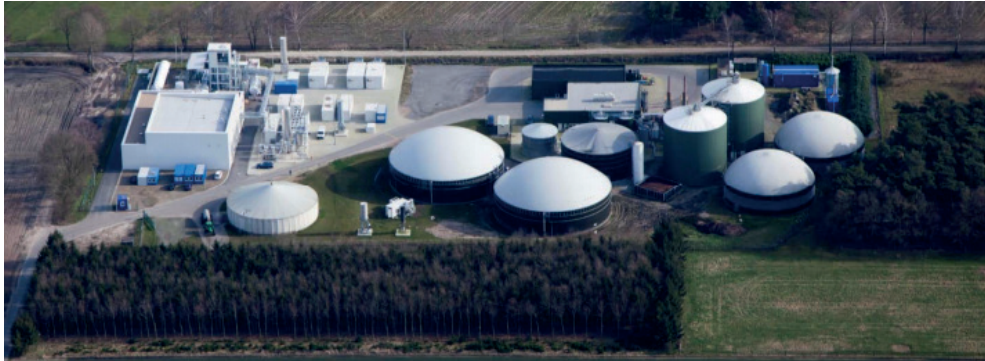
FIGUUR 12 ETOGAS P2G INSTALLATIE (BRON: EWE NETZ)
