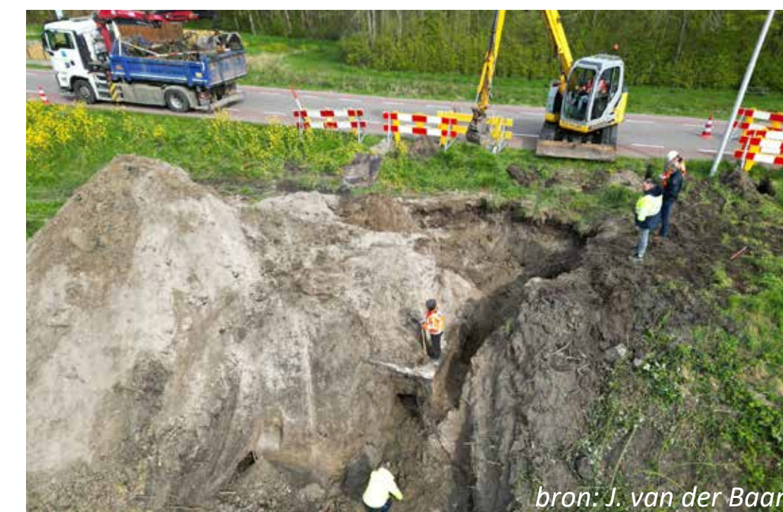
schade en verzakkingen
